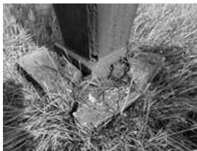
Рис. 2. Состояние ранее отремонтированного фундамента
