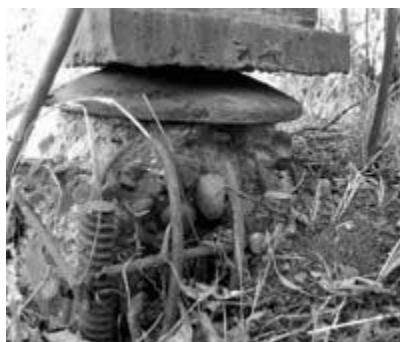
Рис. 1. Дефектный железобетонный фундамент ВЛ 500 кВ
