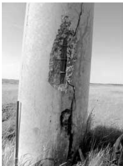
Рис. 3. Дефектная железобетонная стойка ВЛ 110 кВ
